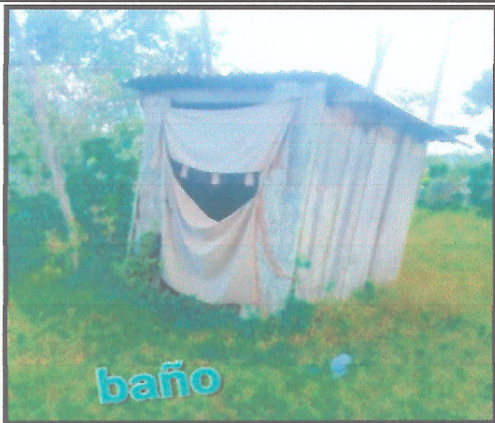
Foto 3: Malas condiciones del servicio sanitario
